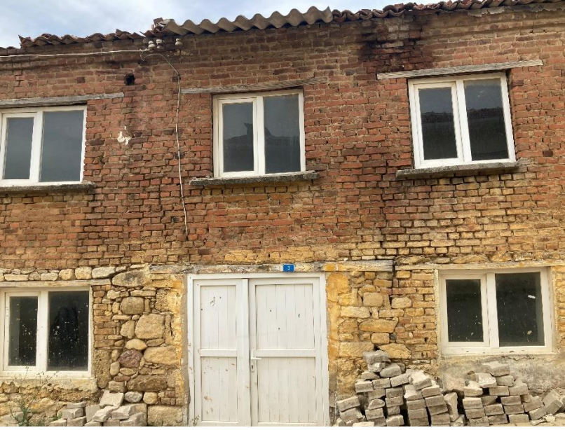
Resim6: Kötü durumda olan bir yapı örneği
